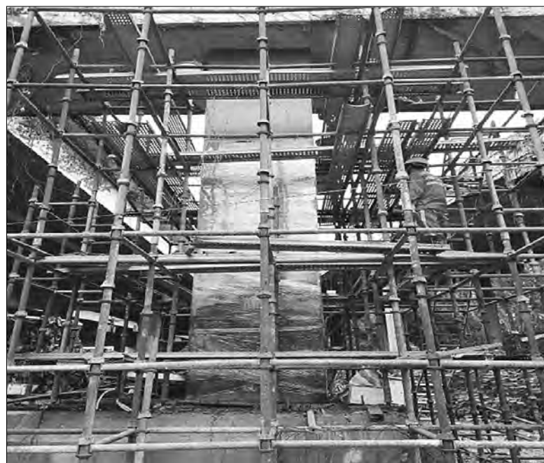
Рис. 2. Установка катодной системы приложенного тока система защиты и усиления конструкций (ICCP-SS) опор авто-страды Гуанчжоу–Шэньчжэнь
