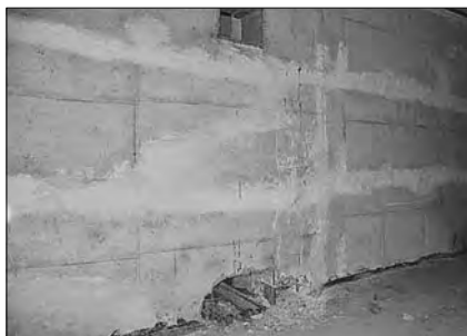
Рис. 14. Сквозные вертикальные трещины в диафрагмах жесткости в зоне ввода коммуникаций
