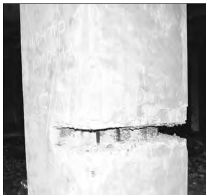
Рис. 3. Центральная колонна подвала омоноличена рыхлым бетоном с включениями строительного мусора Fig. 3. The central column of the basement is cast with loose concrete with inclusions of construction debris
