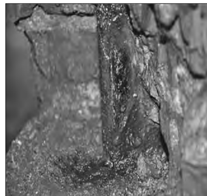
Рис. 4. Состояние металла колонны подвала в осях 4/Б после вскрытия кирпичной облицовки Fig. 4. The state of the metal of the basement column in the 4/B axes after opening the brick cladding
