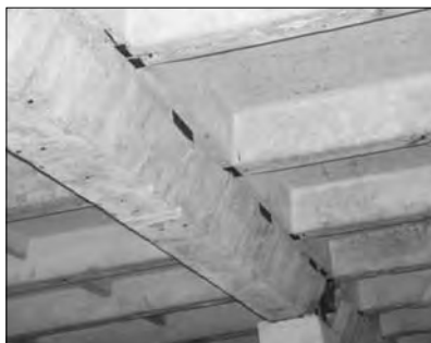
Рис. 8. Отсутствие приварки закладных деталей ребристых плит с закладными деталями ригелей вследствие их смещения. Малая ширина зоны опирания плит на ригели Fig. 8. Lack of welding of embedded parts of ribbed plates with embedded parts of girders due to their displacement. Small width of the bearing zone of the slabs on the girders
