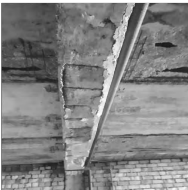
Рис. 11. Аварийные участки перекрытий с разрушениями балок и плит Fig. 11. Emergency floor areas with destruction of beams and slabs
