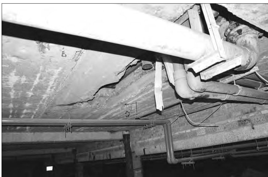
Рис. 16. Разрушение плиты перекрытия в зоне прокладки труб
